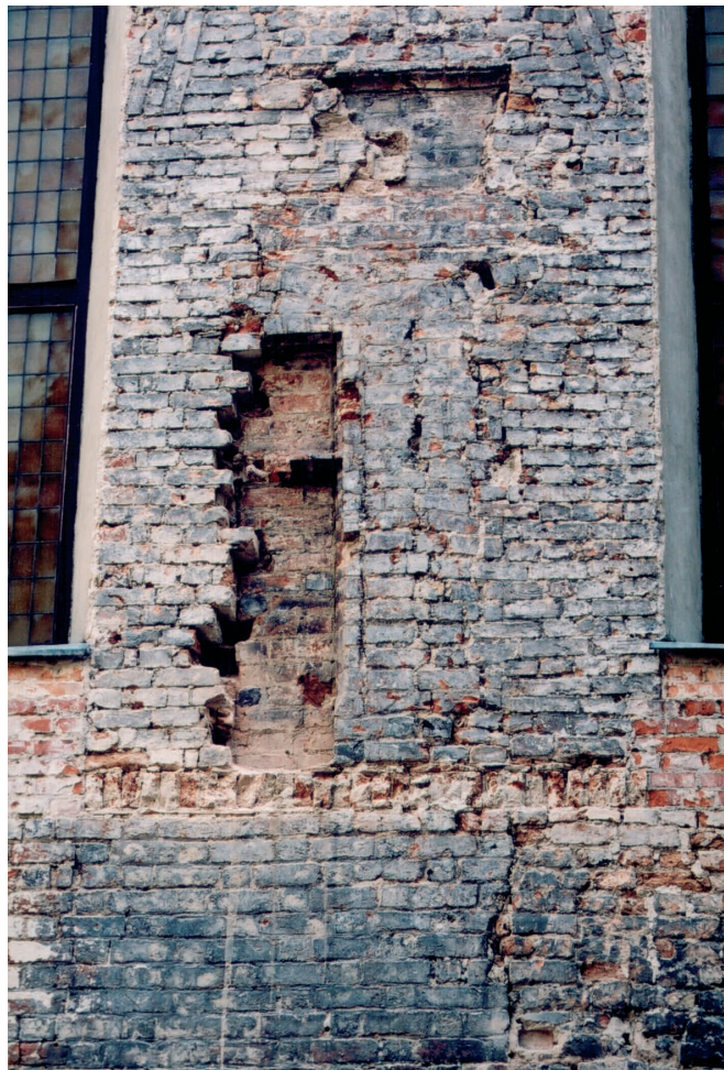
Pałac Górków - fragment pierwotnej dekoracji pałacu A. Szamotulskiego. Widoczne ślady ozdobnych blend i okna. Fot. J. Skuratowicz
